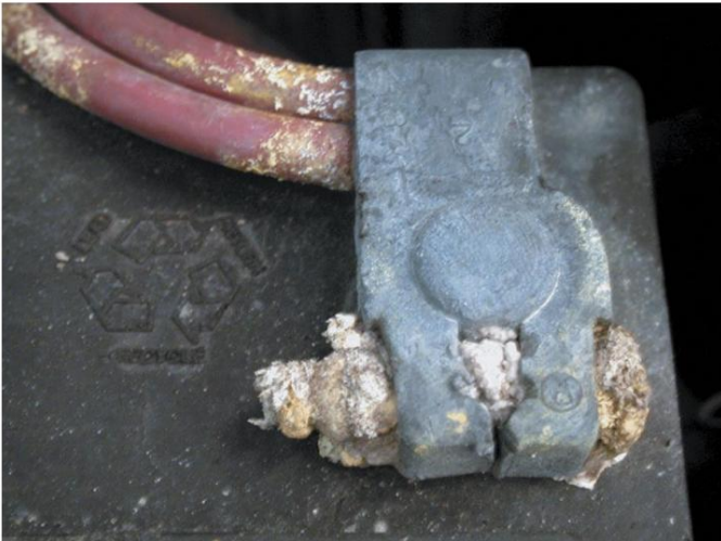
Figura 18. Las conexiones de cables corroídas pueden provocar un arranque lento.
