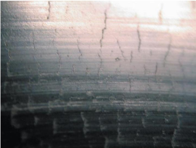
Figura 10. Un tambor con control de calor debe ser reemplazado.
