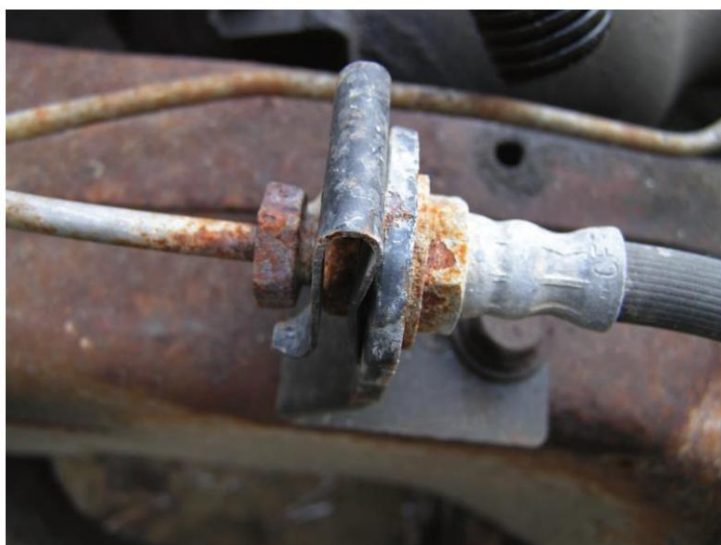
Figura 32. Verifique si hay fugas en las conexiones del sistema hidráulico.
